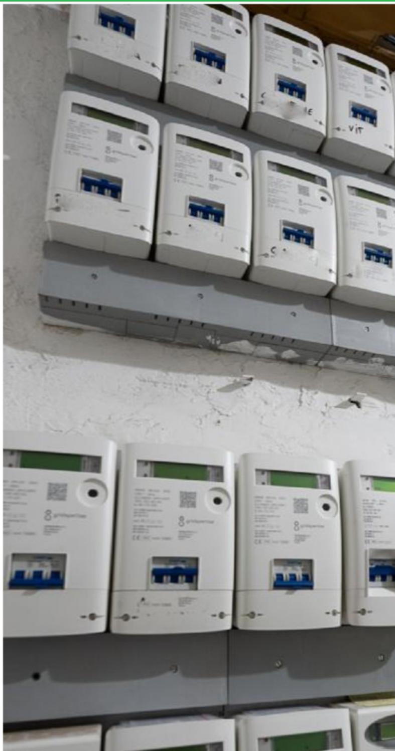
Energia Un gruppo di contatori elettrici
